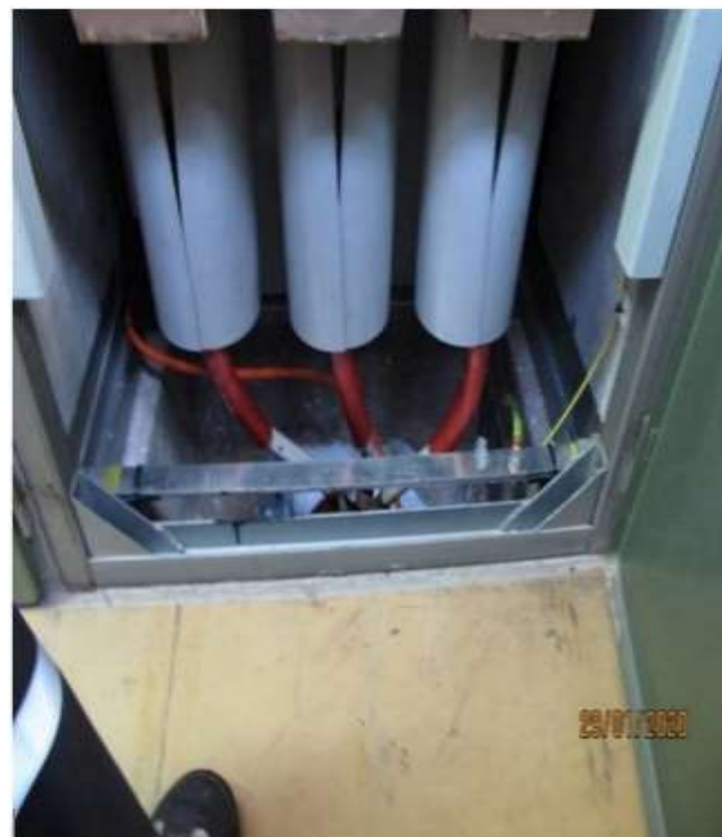
Obr. 1: Rozvaděč 9BA.15 – optické vlákno bylo přichyceno pod zemnicí pásovinou
